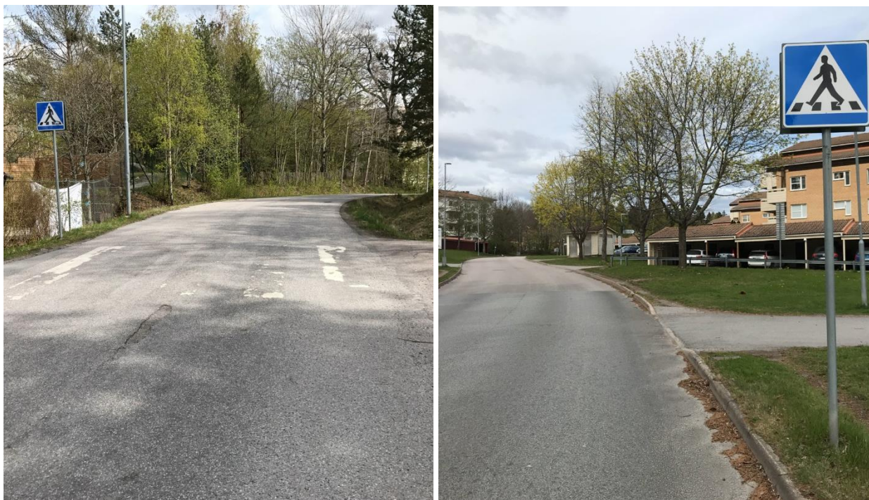
Figur 20. Övergångställe över Skinnaråsvägen intill skola med sliten vägmålning (till vänster) och övergångställe över Rotsundagårdsvägen som saknar vägmålning (till höger)
